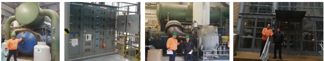
Planta de cogeneración de energía del MIT con Seth Kinderman
